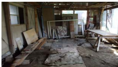
小屋の敷地の外側、泥の撤去後です。
